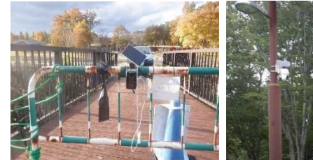
監視カメラ設置状況
