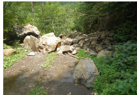
林道上の落石の状況
