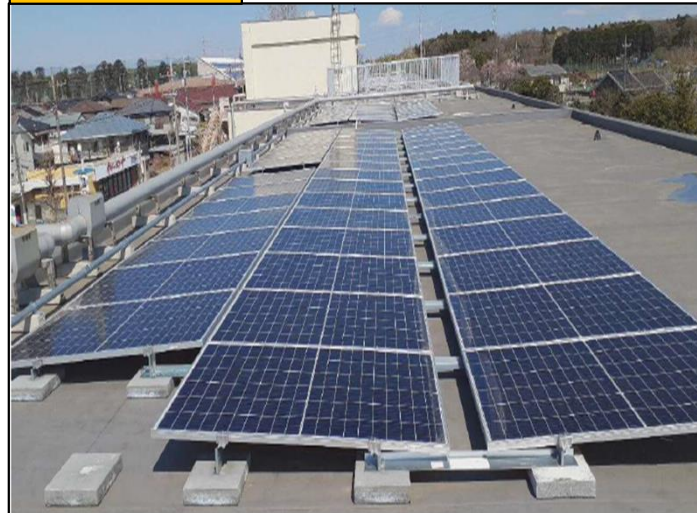
太陽光パネル
