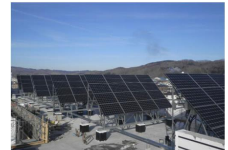
同時導入された太陽光発電設備
