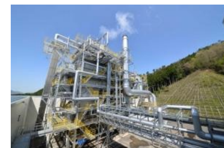
真庭バイオマス発電所
