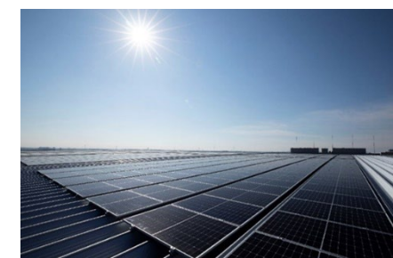
屋上太陽光パネル
