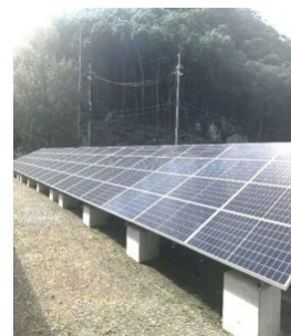
設置した太陽光パネル
