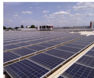
太陽光パネル
