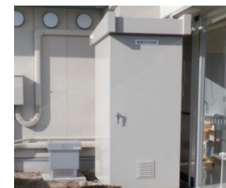
蓄電池 (駅東地域交流センター)
