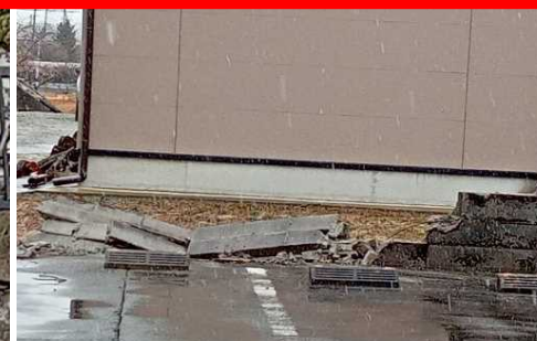
ブロック 塀の倒壊
