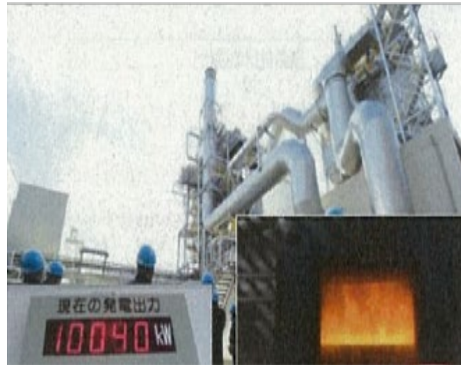
稼働中の木質バイオマス発電施設
