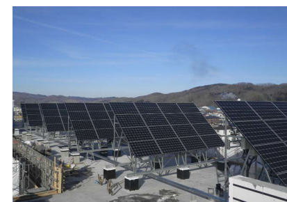
同時導入された太陽光発電設備
