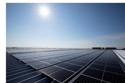
屋上太陽光パネル
