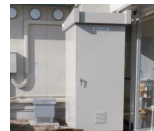
蓄電池 (駅東地域交流センター)
