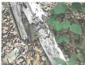
支え木の腐朽(秋 B-1)
