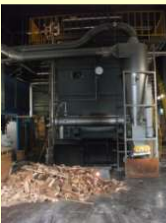
木屑炊きボイラー
