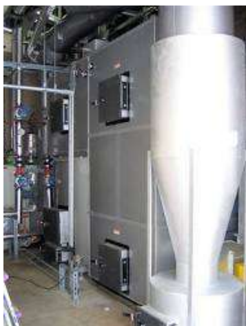
(木質ペレットの製造プラント)
